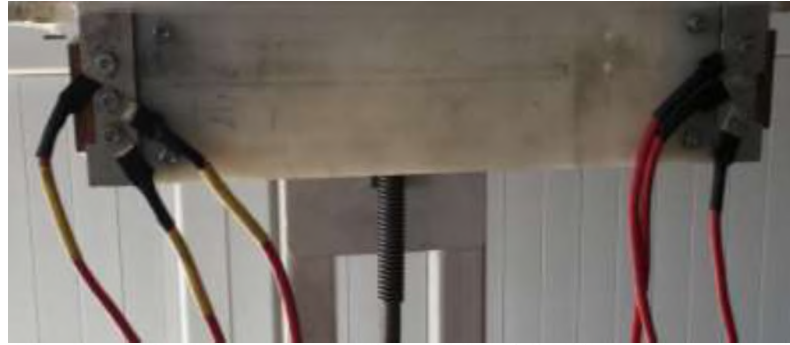
Resim 3.6. DC güç kaynağına elektrik bağlantı elemanları
