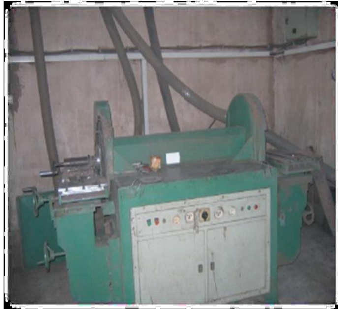
Resim 2.2 Asbest tozu bulunan havalandırma sistemi parçası (Arseven, 2005).
