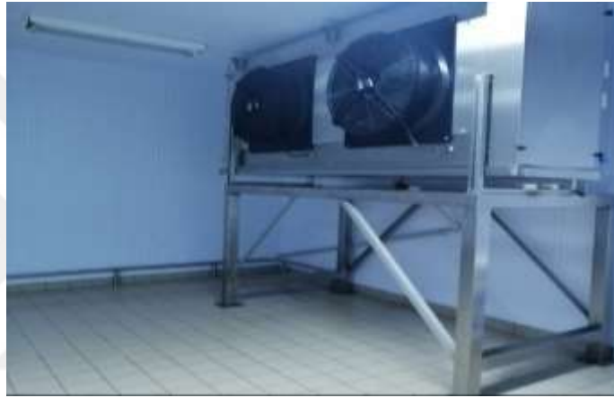
Resim 3.8. İnkübasyon Sonrası Soğutma Odası
