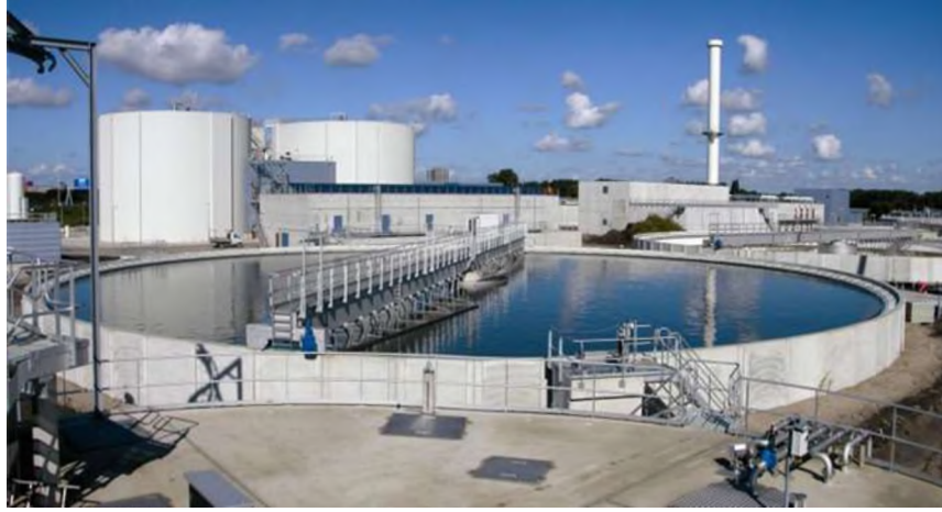
Şekil 4.6 Atıksu arıtma tesisi
