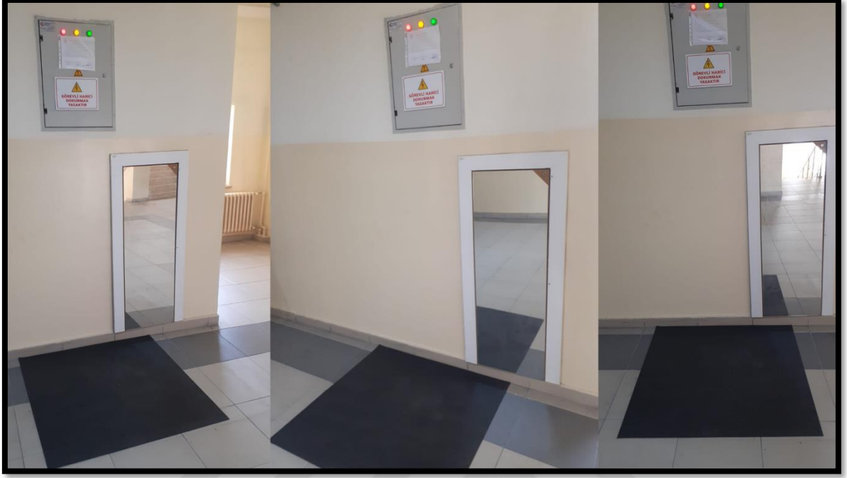
Resim 8: Elektrik Panoları ve Yalıtkan Paspasları
