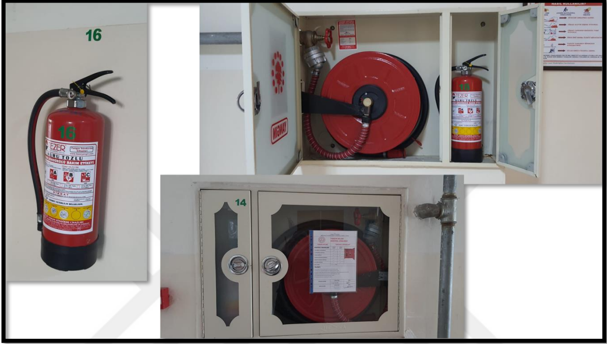
Resim 7: Yangın Tüpleri ve Yangın Dolapları
